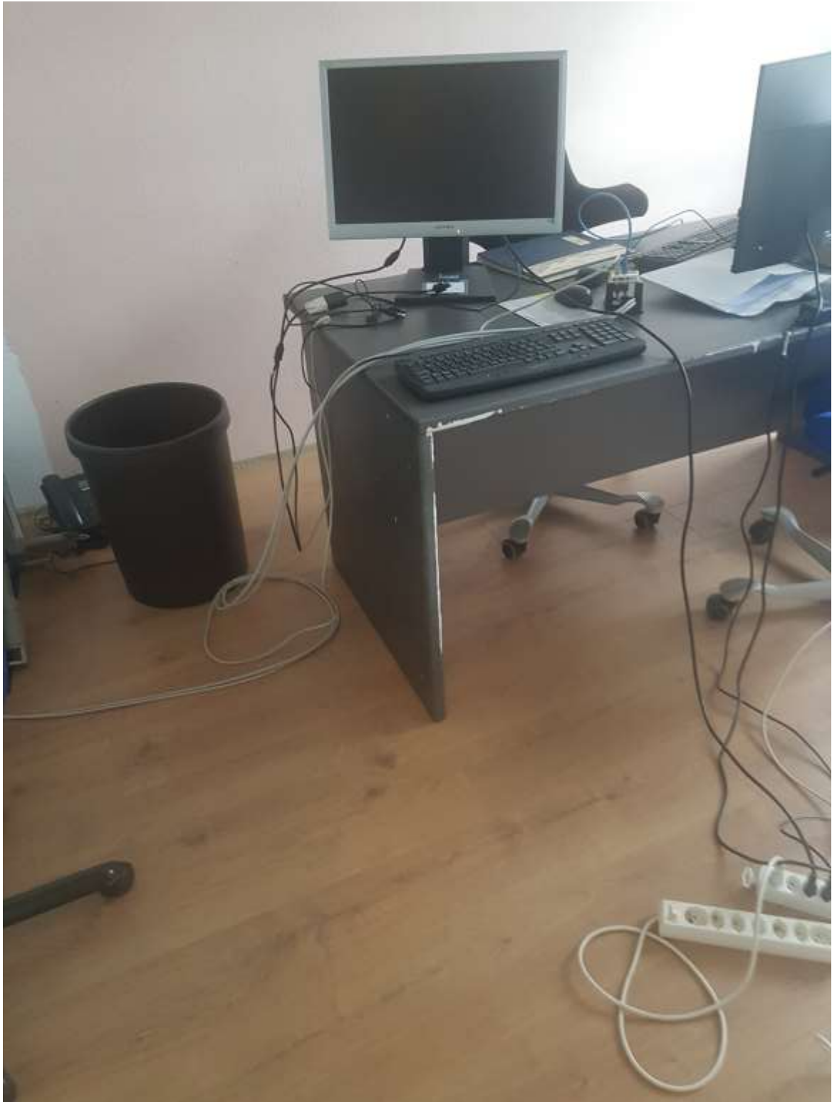
Laminatverlegung und Boden Erhöhung um 4 cm in den Zimmern mit Spezial Dammatten, Treuhandbüro Trevista Treuhand- und Revisionsgesellschaft AG Bürkihof 4 8965 Beriken 2020 Tel: 0041 056 633 02 33 Herr Abt
