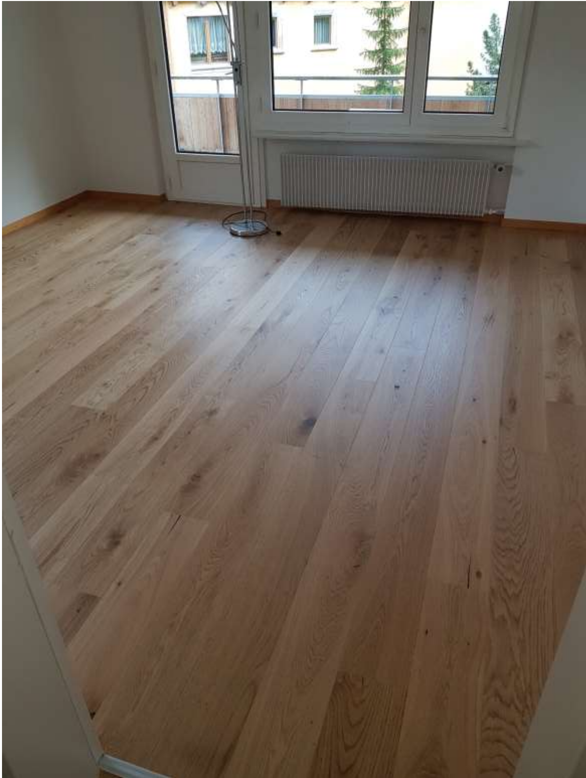
Parkett mit Boden Erhöhung in den Zimmern um 3 bis 4 Zentimeter mittels Spezial Dammplattend in Arosa in 4 ½ Wohnung Zimmer und Gang 2018
